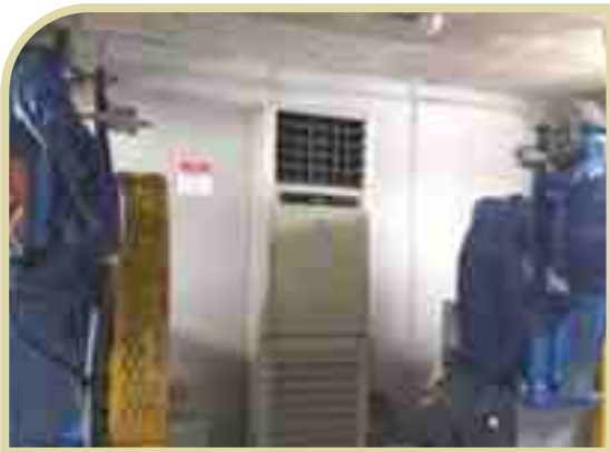
▲ 기계실 내 냉방기 설치 모습
